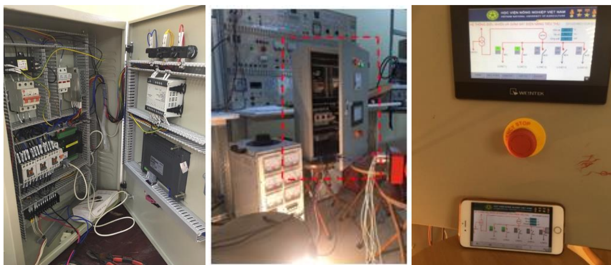
Hình 8. Mô hình hệ thống được xây dựng, lắp đặt thử nghiệm tại phòng thí nghiệm
